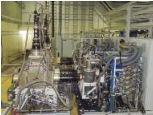
IFMIF RF System, Rokkasho, Japan
